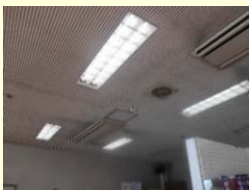
蛍光灯照明器具
