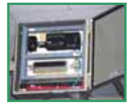
リモートボックス (PLCが収納されている)
